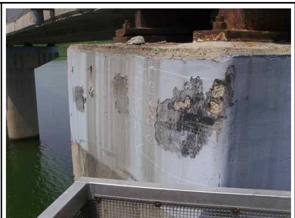
보수부 탈락 (P10)
